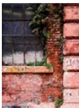
Pág: 29 /37 "Grietas verdes" CAMILA ROMA
